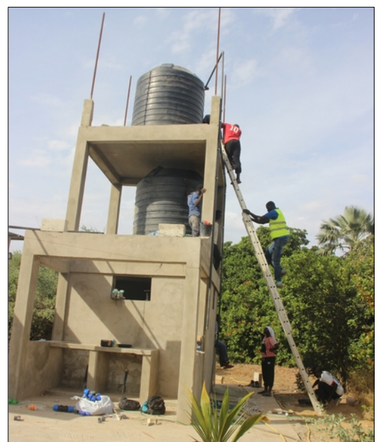
Château d'eau 10.000 l
